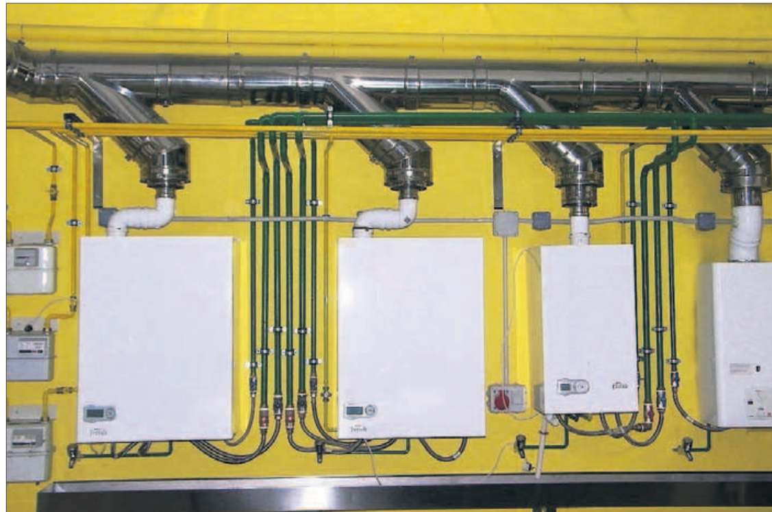
Algunas calderas para la producción de ACS y calefacción instaladas en el taller de formación de Foncalor.
